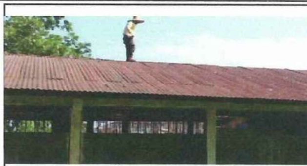
Foto 2: El techo del edificio escolar están dañados se requiere en su totalidad el mantenimiento.
