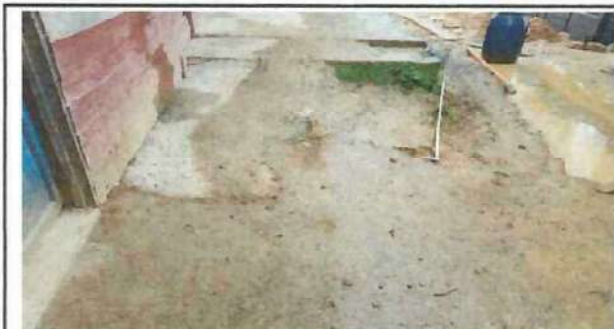
Foto 3: Se ve que es necesario mejorar esa rampa, porque la mitad ya se desborono y dificulta el ingreso a ese edificio
