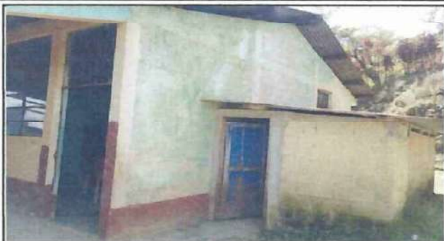
Foto 1: se ve que el estaso de la pintura de la pared del edificio escolar y el servicio sanitario necesita mantenimientos
