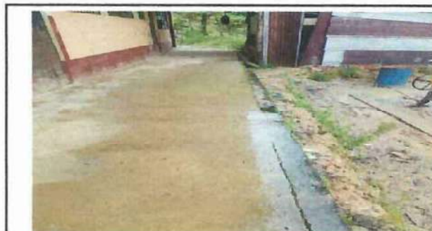
Foto 4: se observa que es necesario realizar mantenimiento el cerquillo de ese corredor es notorio que se encuentra en mala estado.
